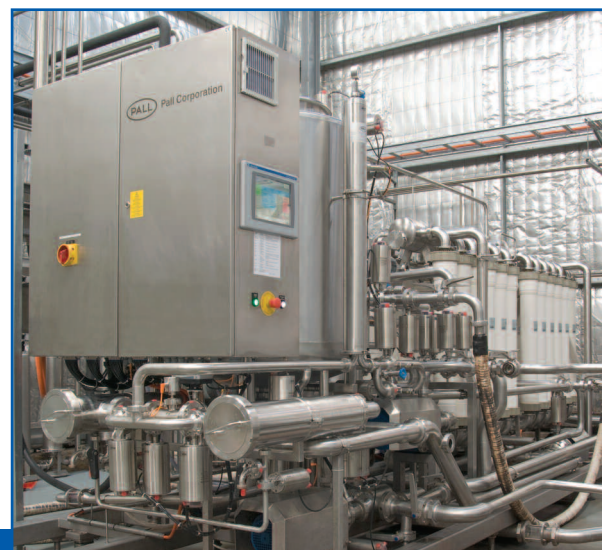
Sistema Oenoflow™ HS-A instalado en Yalumba
